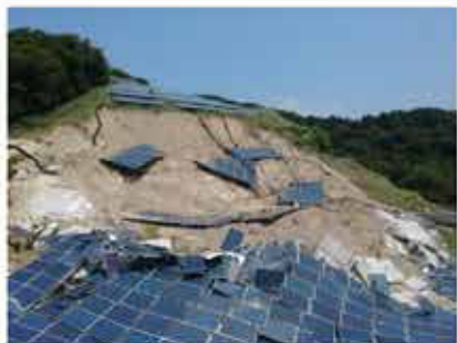
土砂崩れで生じた崩落
